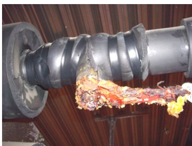
Korrosionsangrepp på ventil
